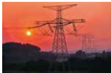
\pm 800 千伏云广特高压直流输电示范工程
