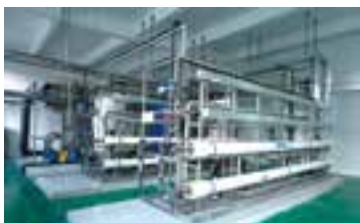
华润水泥垃圾处置反渗透系统
