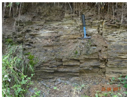
图4 鄂尔多斯盆地南部旬邑露头长7油层组页岩高角度构造裂缝
